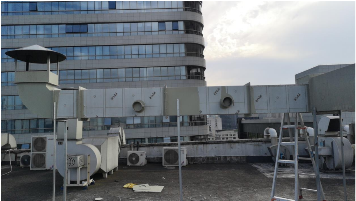
样品检测废气处理设施及排气筒
